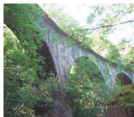
Le viaduc aujourd'hui, envahi par la végétation
