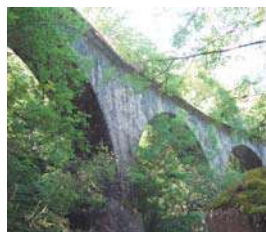
Le viaduc aujourd'hui, envahi par la végétation
