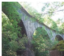
Le viaduc aujourd'hui, envahi par la végétation
